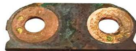
Rysunek 5. Uszkodzony łącznik modułów akumulatora trakcyjnego. Widoczne ubytki materiału i liczne wypalenia. Toyota Auris Hybrid
