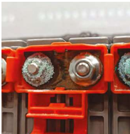
Rysunek 3. Połączenia elektryczne modułów akumulatora trakcyjnego. Toyota Auris Hybrid
