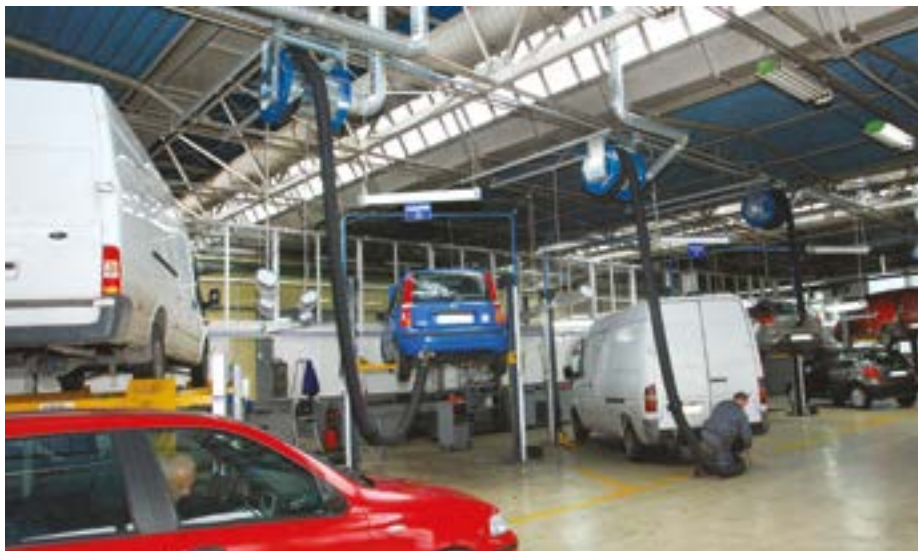
Fot. 2 – Bębnowy wyciąg spalin
