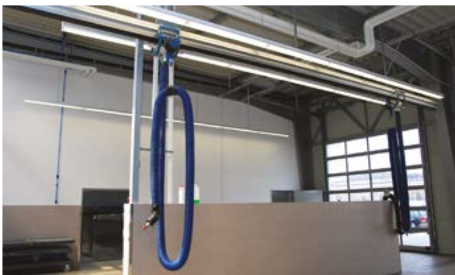
Fot. 4 – Szynowy wyciąg spalin
